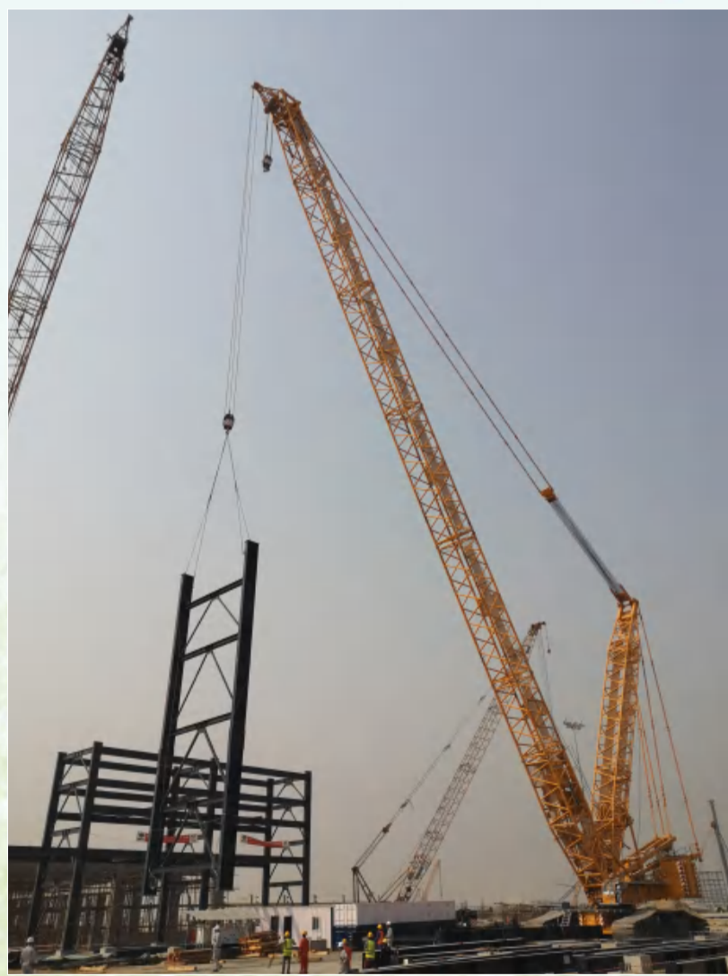
龙安集团尼日利亚丹格特炼油及石化项目催化裂解汽油脱硫装置(B2 标段)工程,目前正在紧张施工中。该工程合同额 4429.92 万美元(约 3 亿元人民币),工程内容包括催化裂解汽油脱硫装置 B2 标段内钢结构安装、设备管道安装、电气仪表、消防给排水、防腐保温等安装工程。工期自 2018 年 8 月 1 日至 2019 年 12 月 31 日,目前已完成产值 1407.57 万元。
