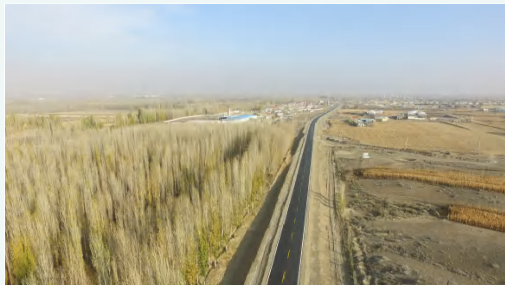
由龙建新疆公司承建的 (X208) S205 线 K83 线岔口-温泉县项目,位于新疆博州博乐市,目前已经完成大部分路段的垫层、基层、路面及全线 80%桥涵的施工。凭借过硬的工程质量、良好的驻地建设和重大的战略意义,该项目荣获自治区“建设杯”、“安康杯”优胜单位、博州优秀施工项目部奖,为当地“交通+旅游”融合发展打开了空间。
